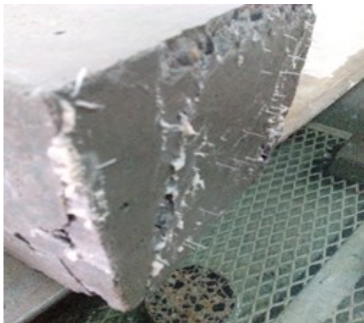
شکل ۹. تشکیل رسوب کربنات کلسیم جهت ترمیم ترک-
