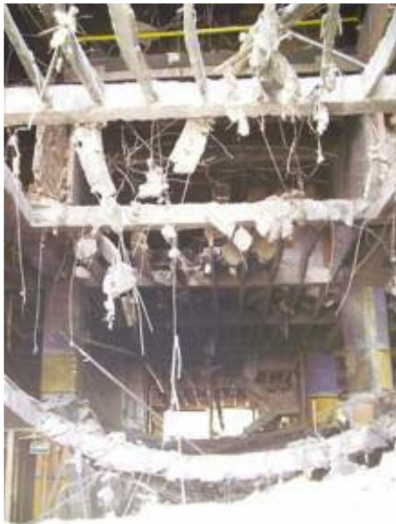
شکل ۱۸- ساختمان خسارت دیده کلپ
