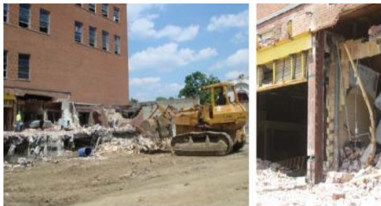
شکل ۷: ساختمان اتحادیه دانشگاه اوهایو و محل ستون‌های حذف شده [۲۶]
