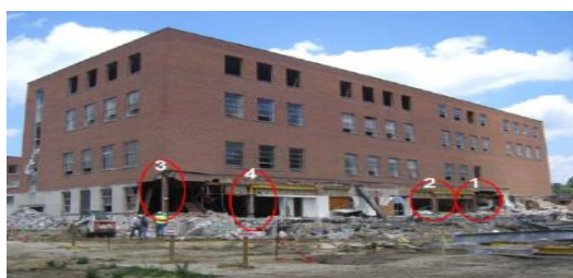
شکل ۶: ساختمان اتحادیه دانشگاه اوهایو و محل ستون‌های حذف شده [۲۶]
