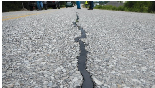
شکل ۱. ترک درزگیری شده
